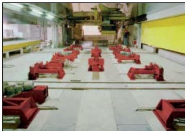
Станция уплотнения бетона
