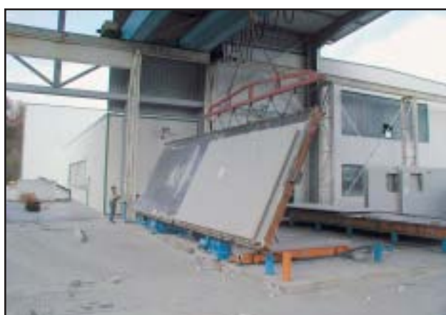
Опрокидывающая станция с закреплённым бетонным элементом
